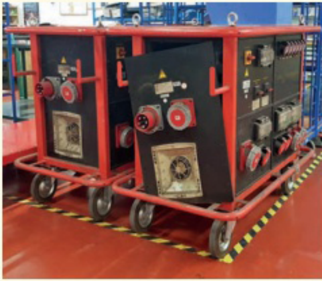
Verteilerwägen zum Umbau und Anpassung an die aktuellen Normen
