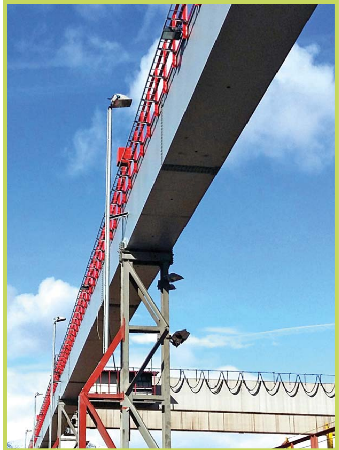
PLAZA FlatLED - Brückenbeleuchtung
