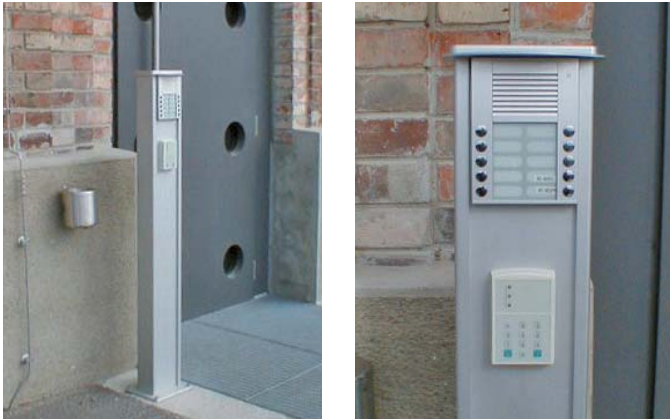
GAS 160 - Zutrittskontrolle Messegelände Wien
