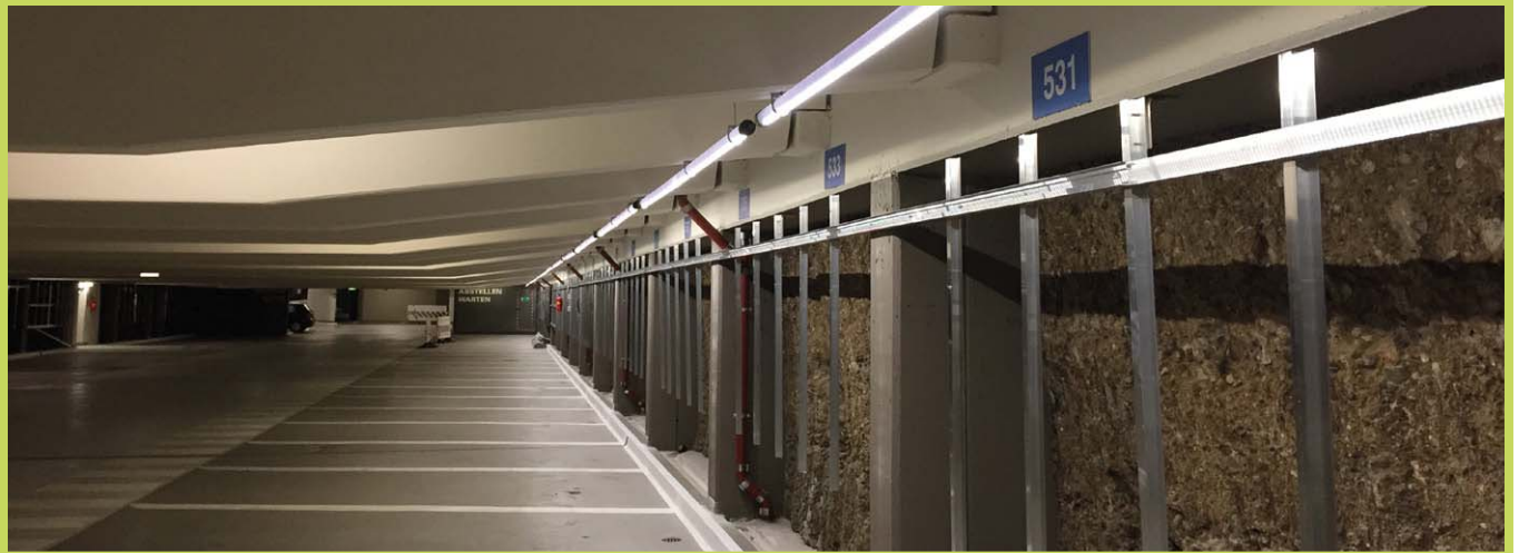
StreamLED Power - Beleuchtung Tiefgarage
