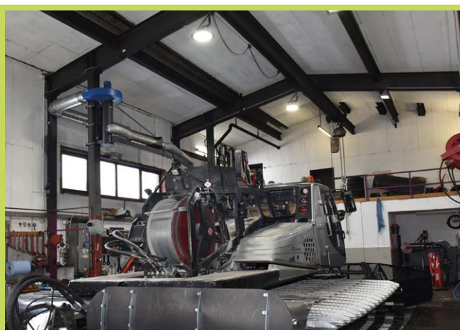
DeltaLUXX - Beleuchtung Pistenraupen-Werkstätte
