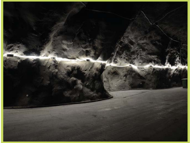
FLEXLED - Beleuchtung im Versuchsstollen
