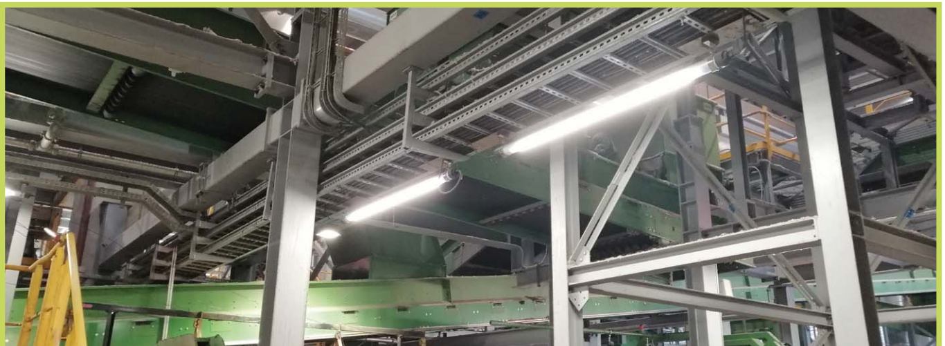
StreamLED Power - Beleuchtung Recyclingzentrum
