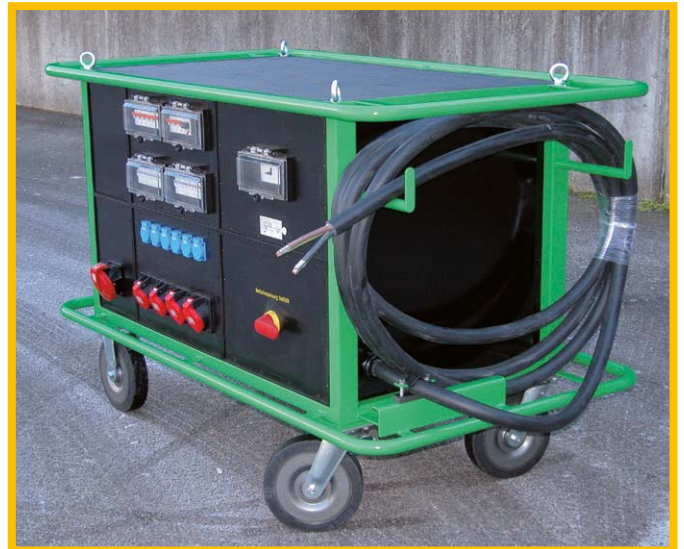
EDV-Nr. 74067, 100kVA 690/400V
