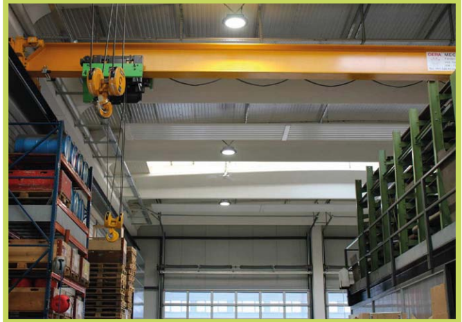
DeltaLUXX - Beleuchtung Lagerhalle
