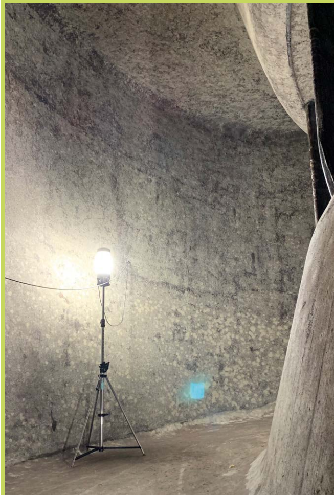
ApolloLED ECO - Beleuchtung bei Revisionsarbeiten in einem Kraftwerk
