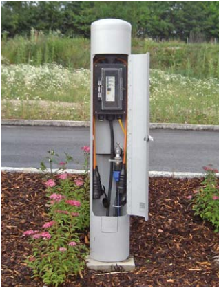
Rondo 200 - zur Ladung von Elektro-Autos Autohaus Schöndorfer in Gallneukirchen
