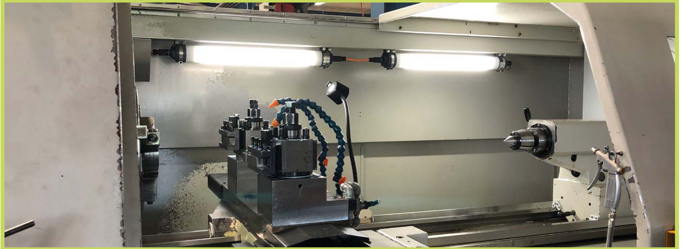
StreamLED Power - Beleuchtung CNC Fräsmaschine
