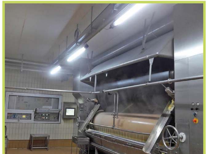
StreamLED Power - Käserei Maschinenbeleuchtung
