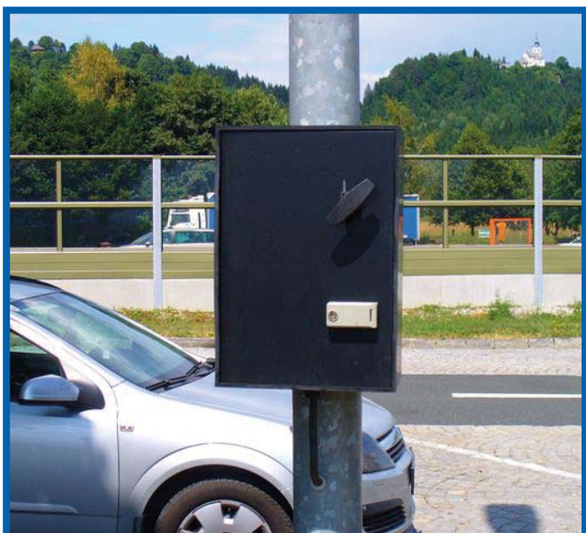
Klemmkasten Ansteuerung Parkplatzbeleuchtung
