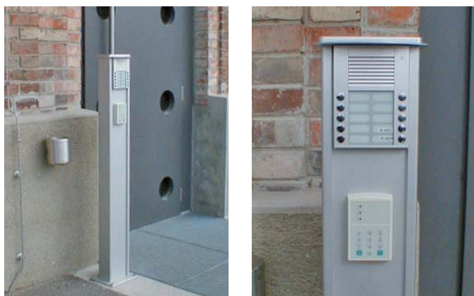
GAS 160 – Kontrola prístupu na výstavnisko Viede
