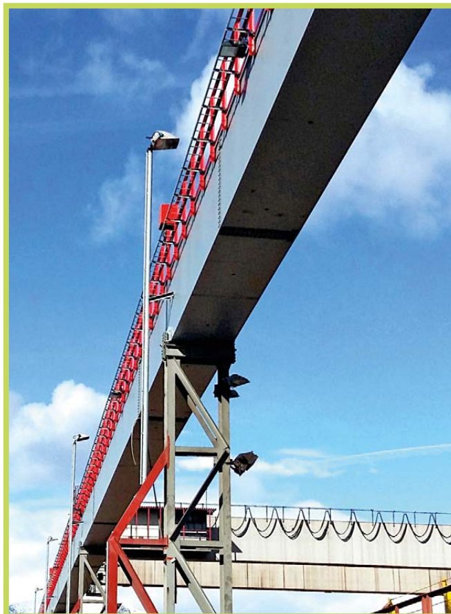
PLAZA FlatLED - Osvetlenie na mostoch / prechodoch
