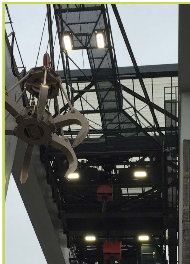
HBL 280W - Osvetlenie portálového žeriavu
