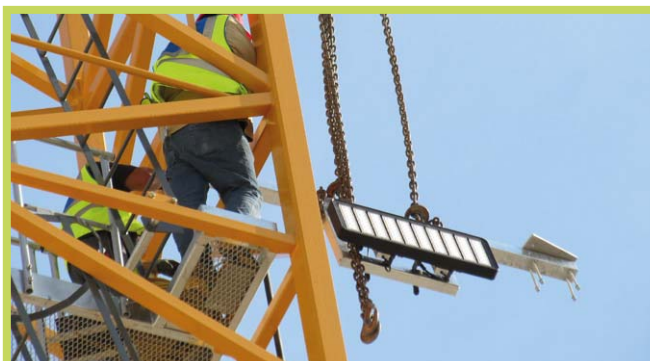
HBL 400W - Osvetlenie portálového žeriavu
