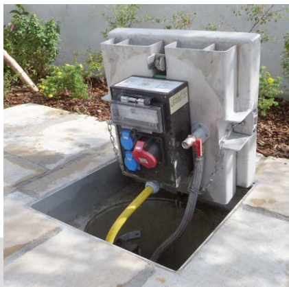
Obec Schneegattern: Podzemný rozvádzač PIAZZA 540 s dvoma káblovými výstupnými otvormi a prípojkou vody.
