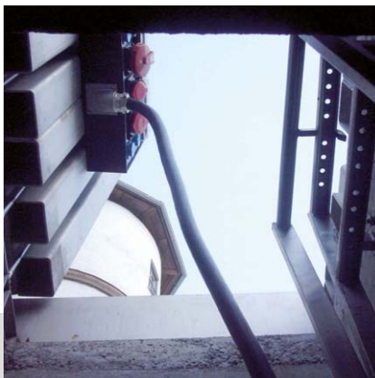
Zámok Junkers, Gotzis: Podzemný rozvádzač Piazza 1000 pre zásobovanie prúdom, a aj ako vstupná šachta.
