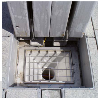
Nové námestie, Klagenfurt: šachta odpadovej vody s mrežou. Šachta môže byť uzatvorená aj počas používania hadice odpadovej vody.
