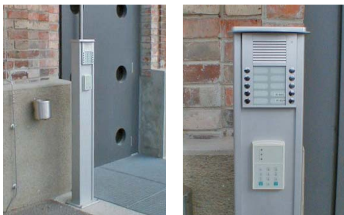
GAS 160 – Kontrola prístupu na výstavisko Viedeň
