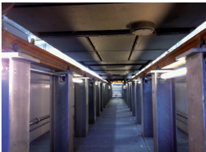
Osvetlenie montážnych jám ÖBB revízia
