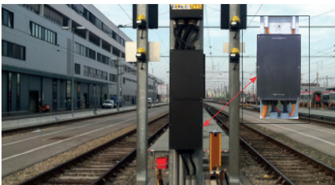
Svorkovnicové boxy pre osvetlenie železnice montované na stĺpe
