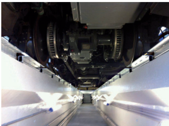
Osvetlenie montážnych jám ÖBB trakcia
