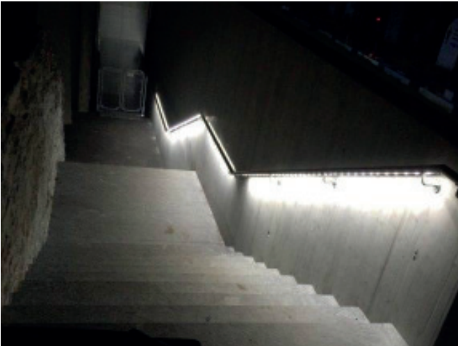
Osvetlenie priestoru vstupného schodiska
